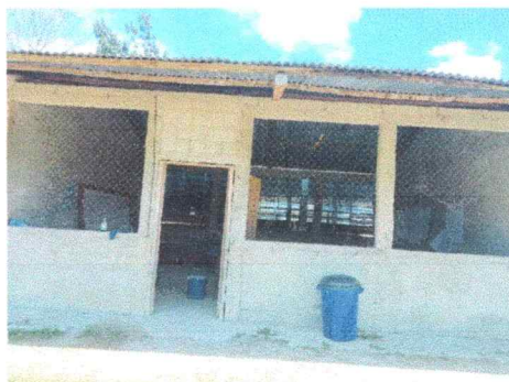
Foto 2: No se cuenta con puerta.
