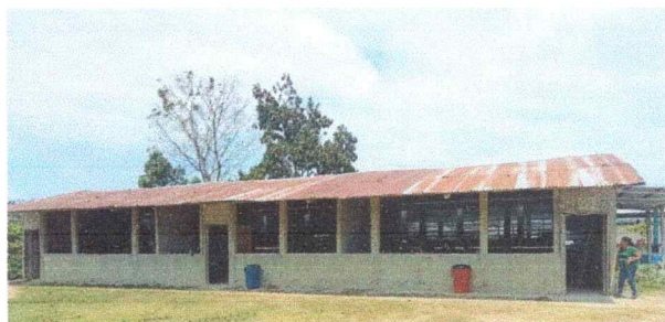
Foto 3: Se observa el deterioro de las láminas.
