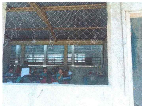
Foto 4: Se observa la falta de balcones.
